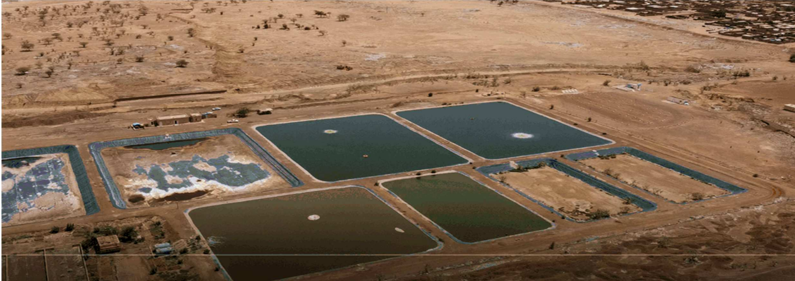
Station de traitement des eaux usées à Zouerate
