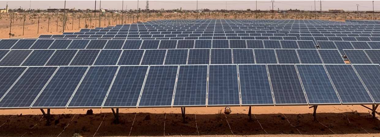
Centrale solaire de Zouerate
